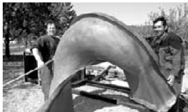
Pracovníci stavební firmy odklízají z budoucí relaxační zóny původní skluzavku, kterou mimochodem někdo několikrát poškodil. Nový dětský areál bude oplocený. FOTO: RB
